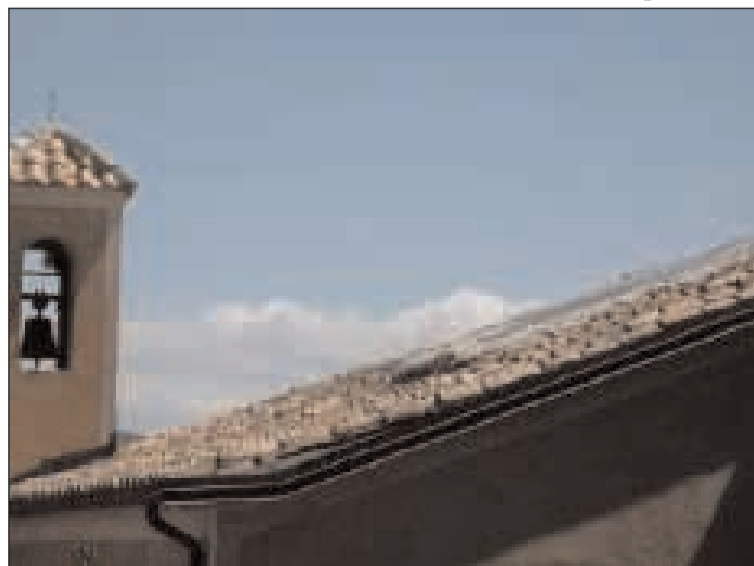
Il tetto della Chiesa di San Bartolomeo danneggiato
