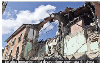
Un'altra immagine della devastazione provocata dal sisma
